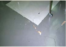
塗り床の亀裂・剥がれ
