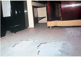
ビニル床シートの剥がれ
